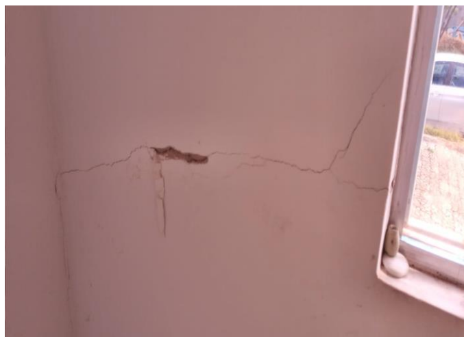
Foto 8 - Rachadura lateral interna – sala odontológica.
