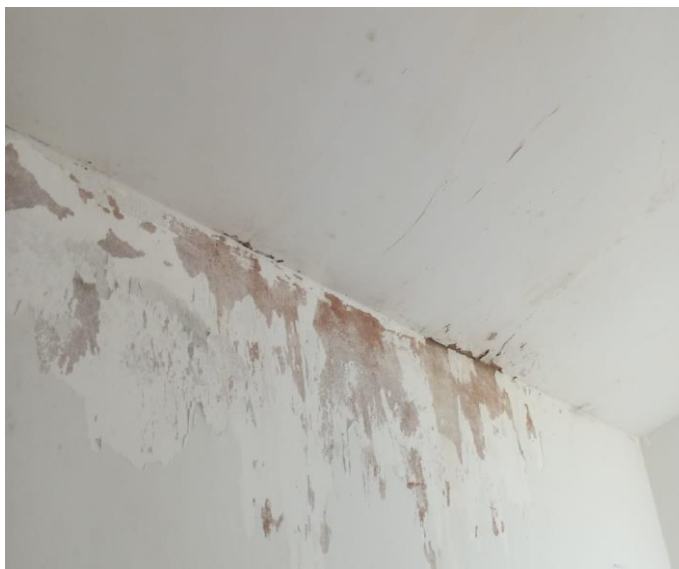
Foto 10 - Infiltrações provocadas por deformação da estrutura do telhado.
