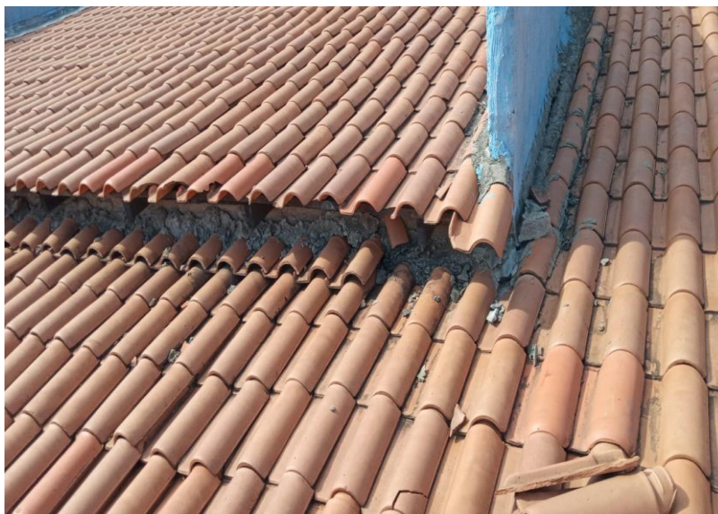
Foto 6 - Telhas deslocadas devida falta de fixação e platibanda frontal e lateral sem rufo.
