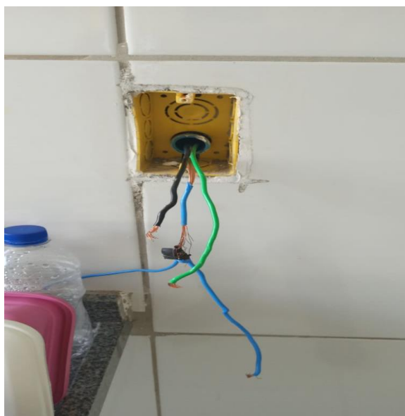
Foto 9 - Instalações elétricas aparente.
