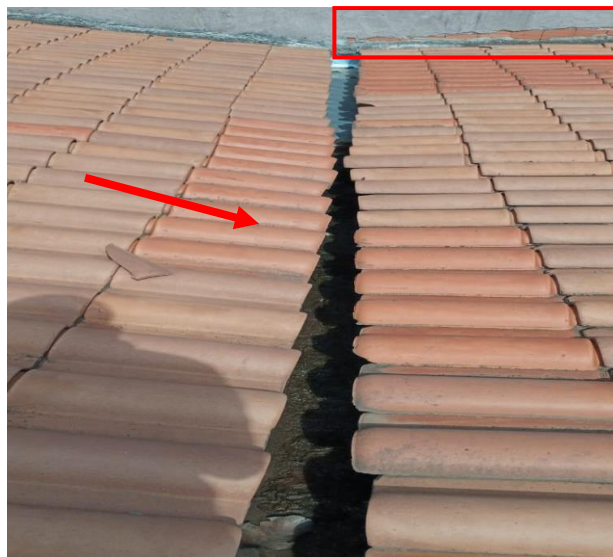
Foto 5 - Telhas deslocadas devido falta de fixação e reboco platibanda lateral inacabado.
