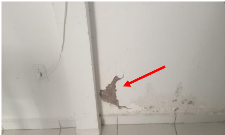
Foto 2 - Infiltrações no rodapé da parede;
