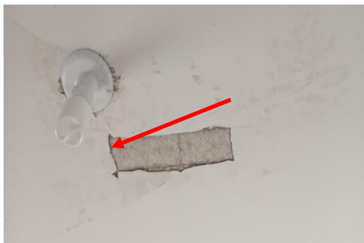
Foto 1 - Ambientes estão apresentando infiltração na laje, resultado de brechas entre as telhas da cobertura.
