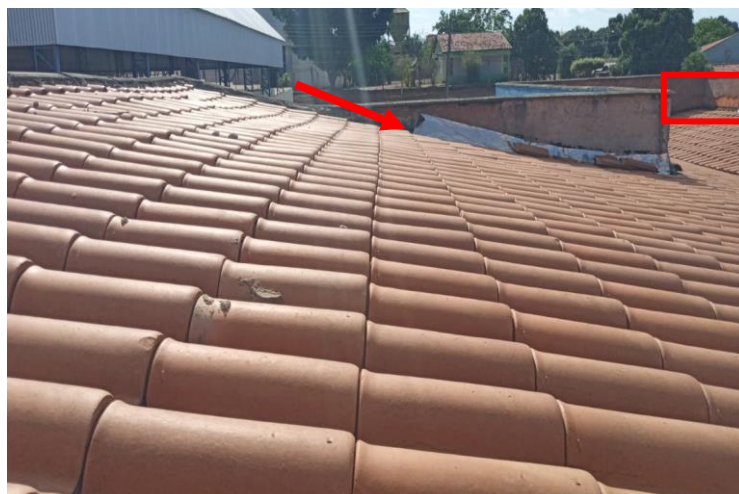
Foto 7 - Telhado com pouca inclinação e reboco na platibanda frontal inacabado.
