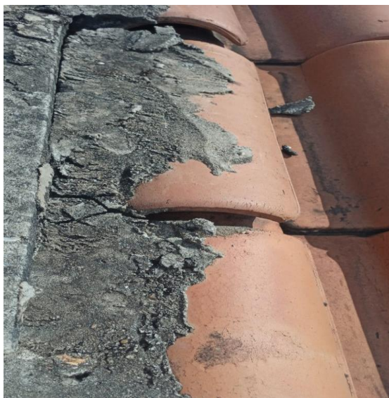
Foto 4 - Telhas deslocadas e platibanda lateral e frontal sem rufos.
