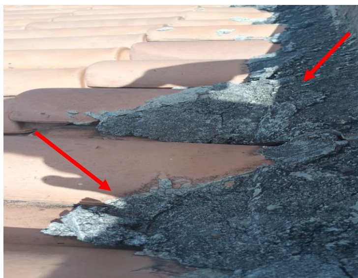
Foto 3 - Telhas deslocadas devido a falta de fixação e platibanda frontal e lateral sem rufos.
